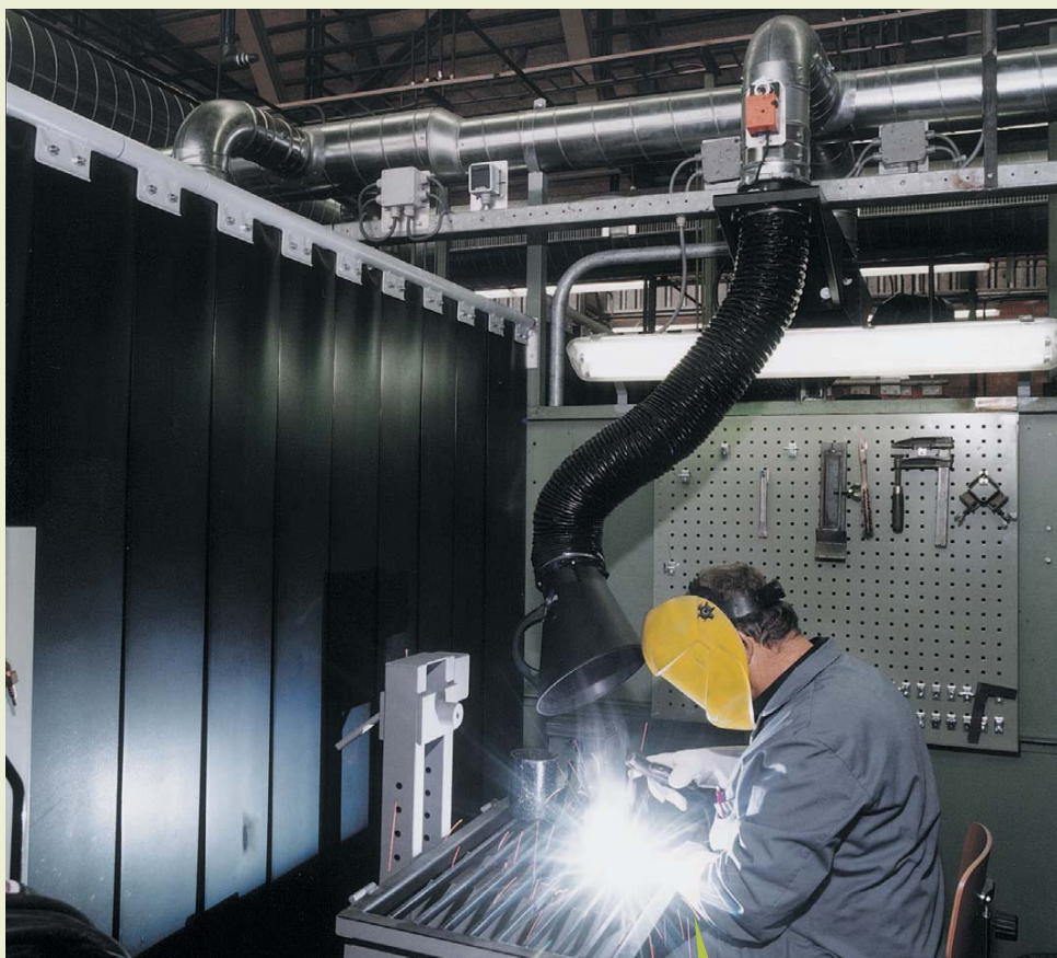
Anwendungsbeispiel: Teleskop-Absaugarm in Schweißkabine
