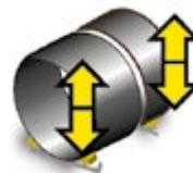
Verbinden der Mantelsektionen auf Rollenböcken mit hydraulischem Fit-up-System UP-Innen- und Außenschweißen mit einer Schweißautomatent­rägerstation
